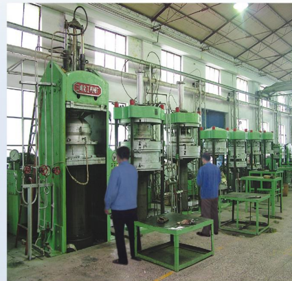
硫化车间 Vulcanization workshop вулканизационный цех
